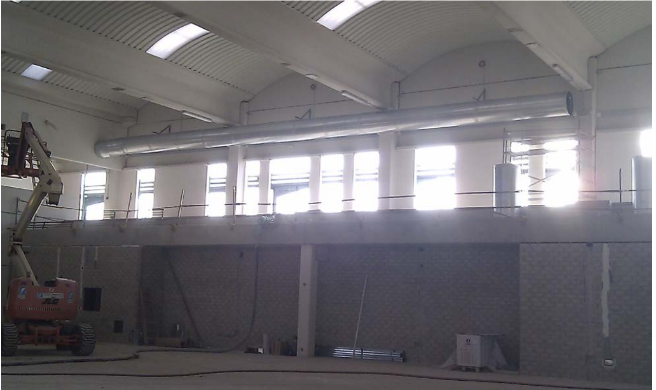
PABELLON POLIDEPORTIVO: INSTALACION DE CLIMATIZACION Y VENTILACION
