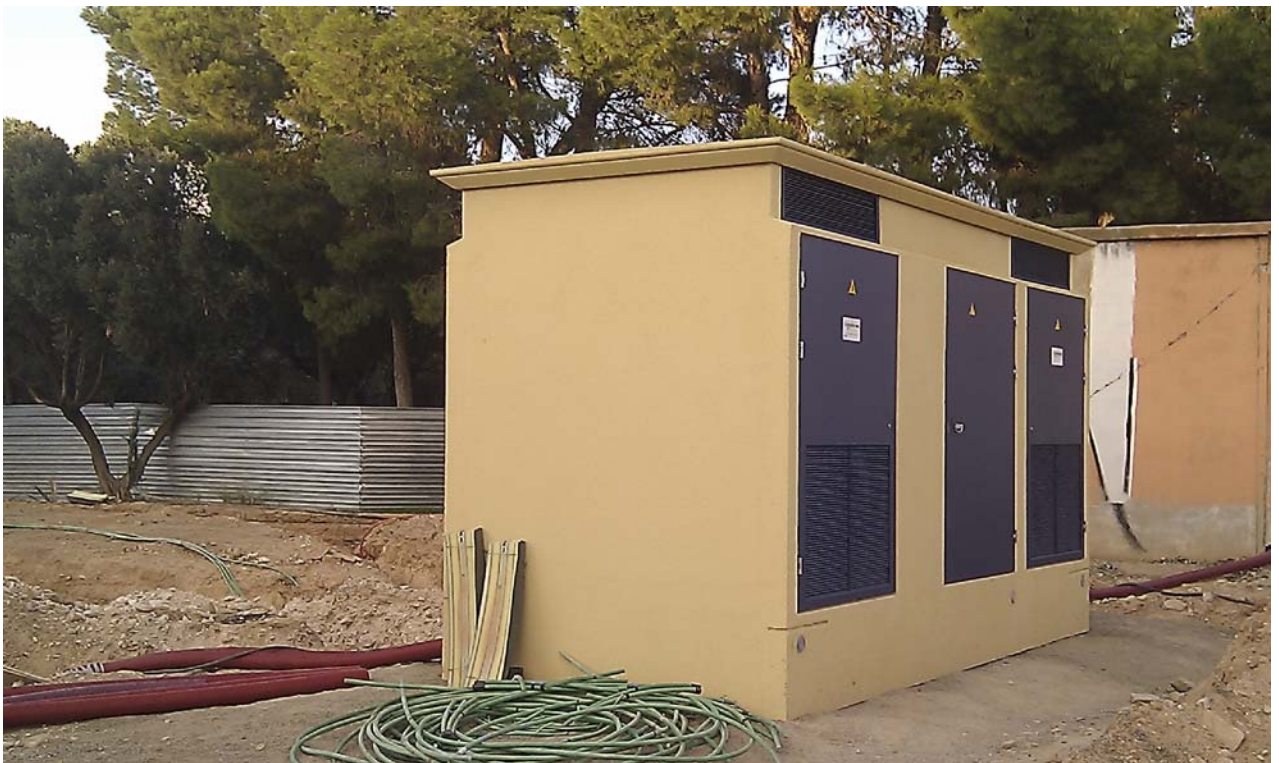
CENTRO DE TRANSFORMACION, SITUADO ENTRE EL PABELLON POLIDEPORTIVO Y EL OLIVAR
