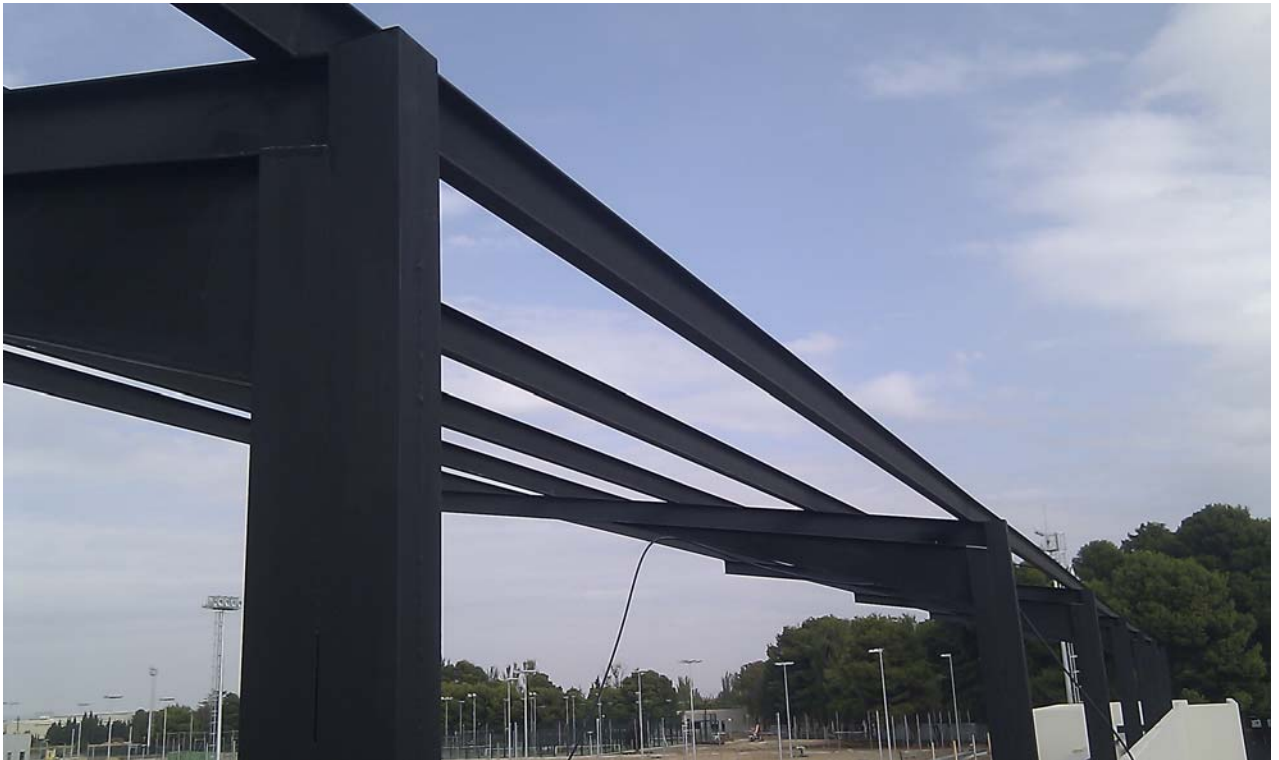
PABELLON POLIDEPORTIVO, TERRAZA PLANTA 1ª: REFUERZO DE MARQUESINA
